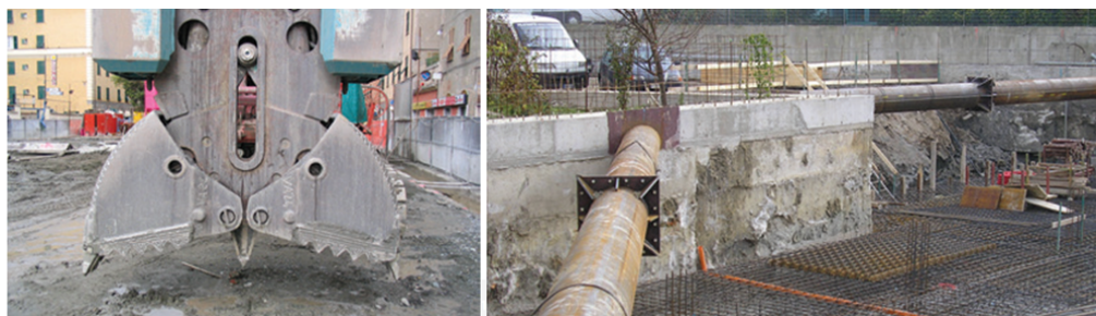
Documentazione esemplificativa fotografica della tecnologia adottata
